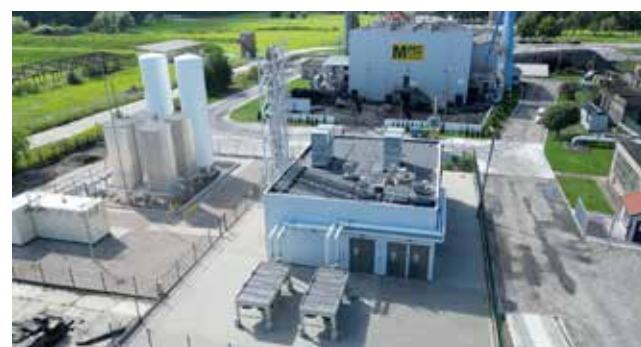
System kogeneracji robi wrażenie – instalacja kogeneracyjna jednocześnie produkuje ciepło i energię elektryczną
