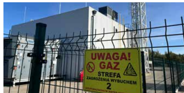
W przypadku instalacji w MPEC Braniewo paliwem jest LNG — skroplony gaz ziemny
